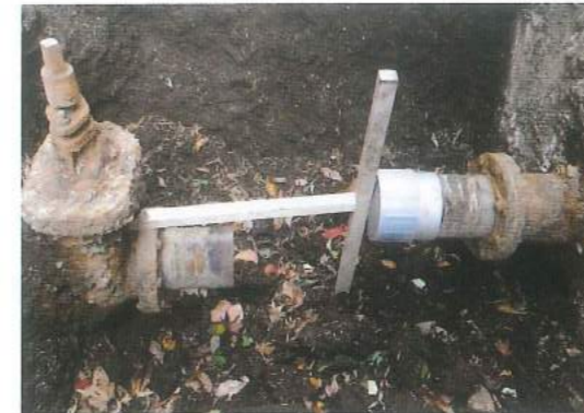
既設可とう管の許容沈下量を越えたので交換
