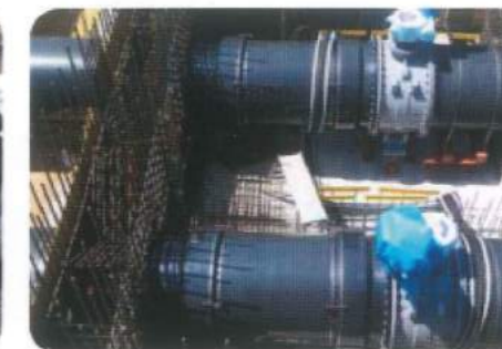
二条管路で、可とう管を使用
