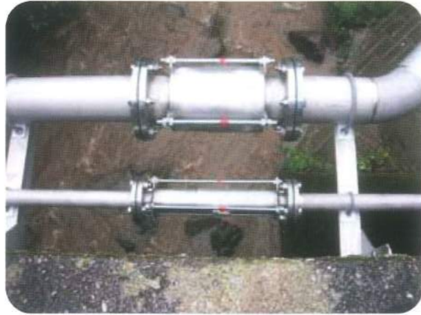
橋梁添架部での異口径二条管路
