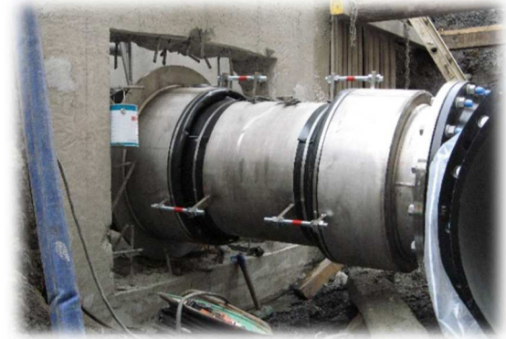
φ600 浄水場埋設部にて使用【MLW】
