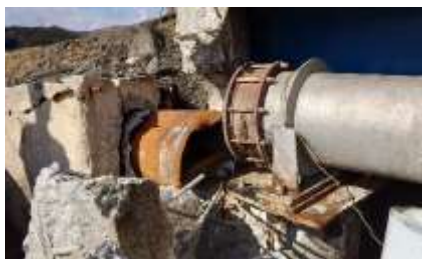
写真1 珠洲市水管橋の脱管被害
