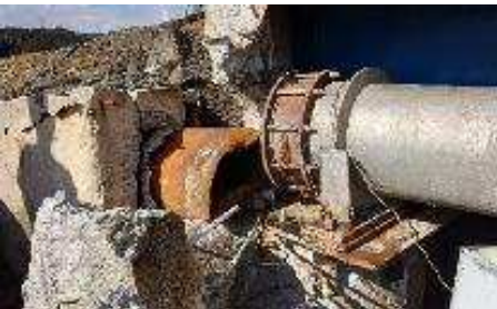
写真1 珠洲市水管橋の脱管被害
