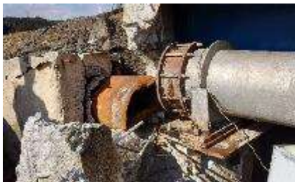
写真1 珠洲市水管橋の脱管被害
