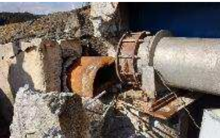
写真1 珠洲市水管橋の脱管被害
